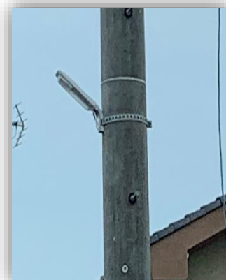
▲町内会で設置された防犯灯(LED灯)
