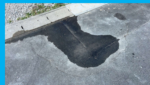
水道管の老朽化に伴う漏水
