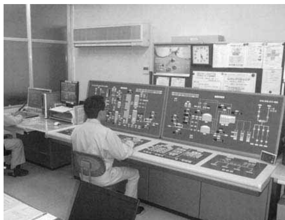
▲又吉配水場中央監視室
