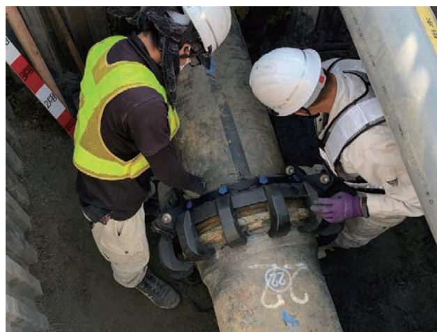
▲水道管をつなぐ継手部分に地震に強い補強金具を取り付けている状況
